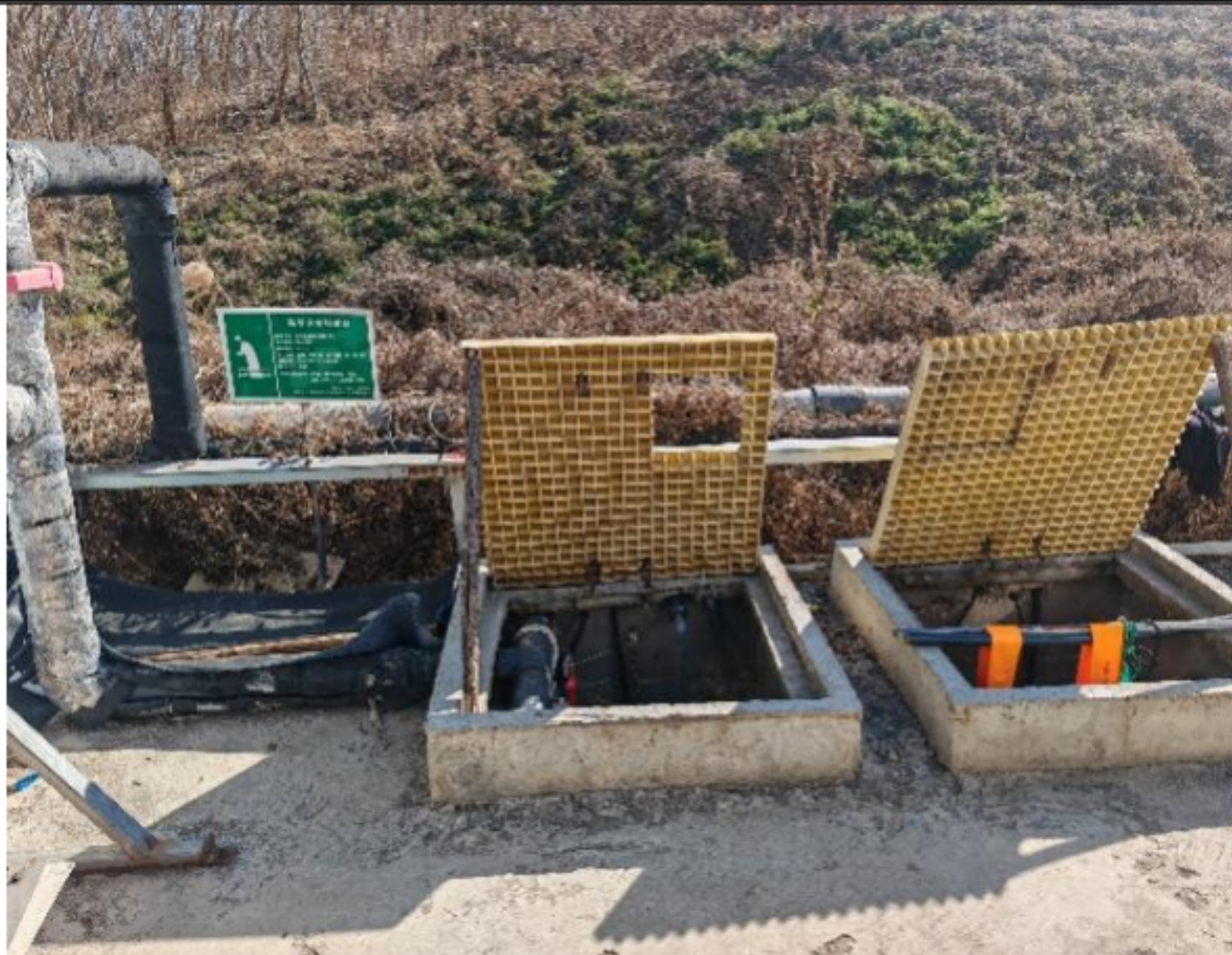
研发中心三期污水处理站总排口排污口规范化设置
